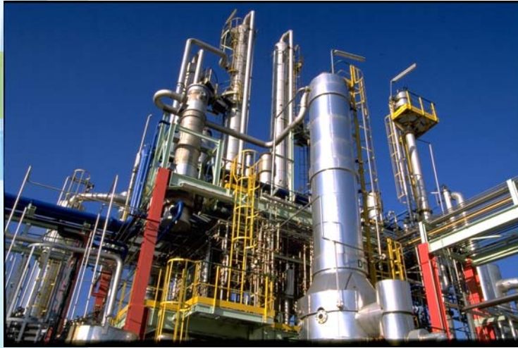
Colonnes de distillation
